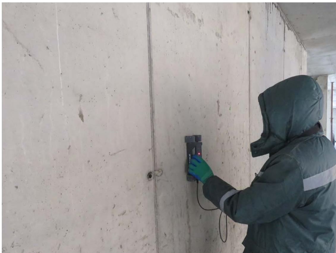
Рис. 4.4.3. Замеры шага арматуры, определение величины защитного слоя бетона в монолитной стене первого этажа магнитным методом прибором «Profometer PM-6»
