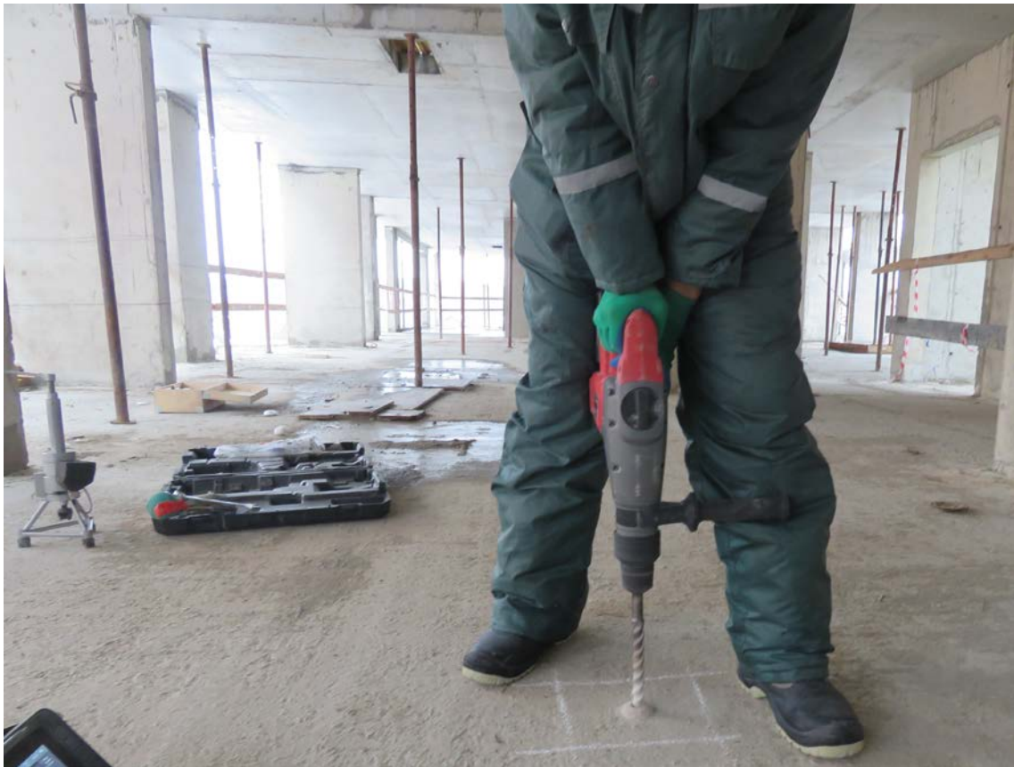
Рис. 4.2.9. Сверление отверстия в монолитной железобетонной плите перекрытия третьего этажа в осях 12/1-14/1/А/1-Б/1
