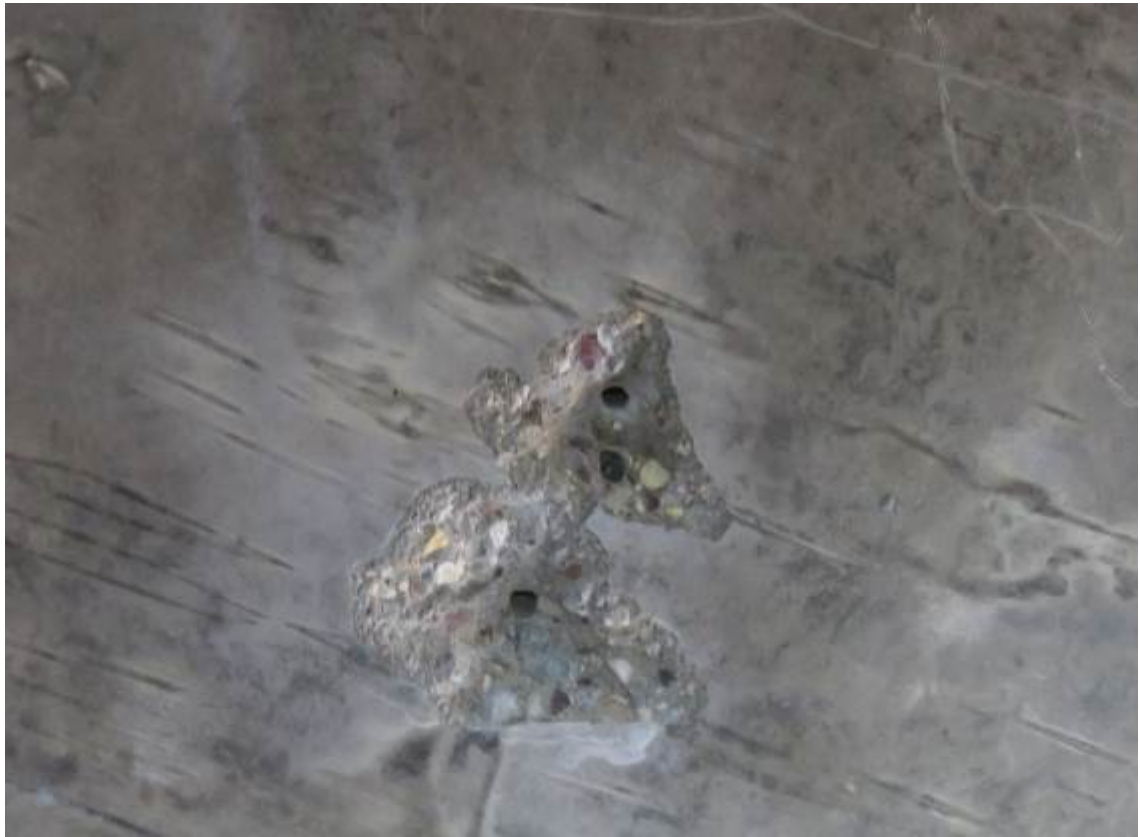
Рис. 3.3.19. Механические повреждения на нижней плоскости плиты перекрытия
