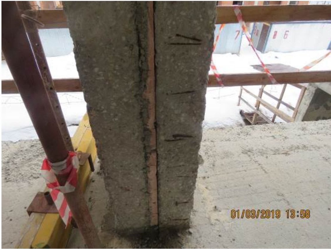
в) Рис.3.2.21 (а, б, в). Оголение и коррозия арматуры монолитных пилонов и стен
