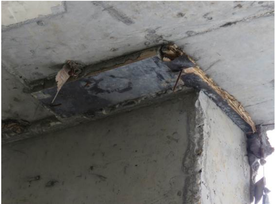
Рис.3.2.23. Посторонние включения в узле сопряжения монолитных пилона и плиты
