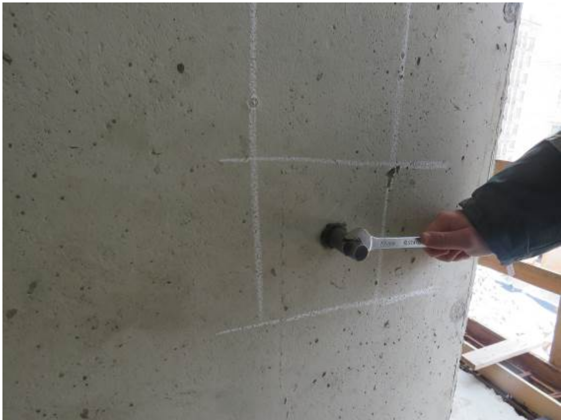
Рис. 4.2.7. Установка анкерного устройства и тяги в отверстии монолитного железобетонного пилона подвального этажа в осях 12/1/А/1-Б/1
