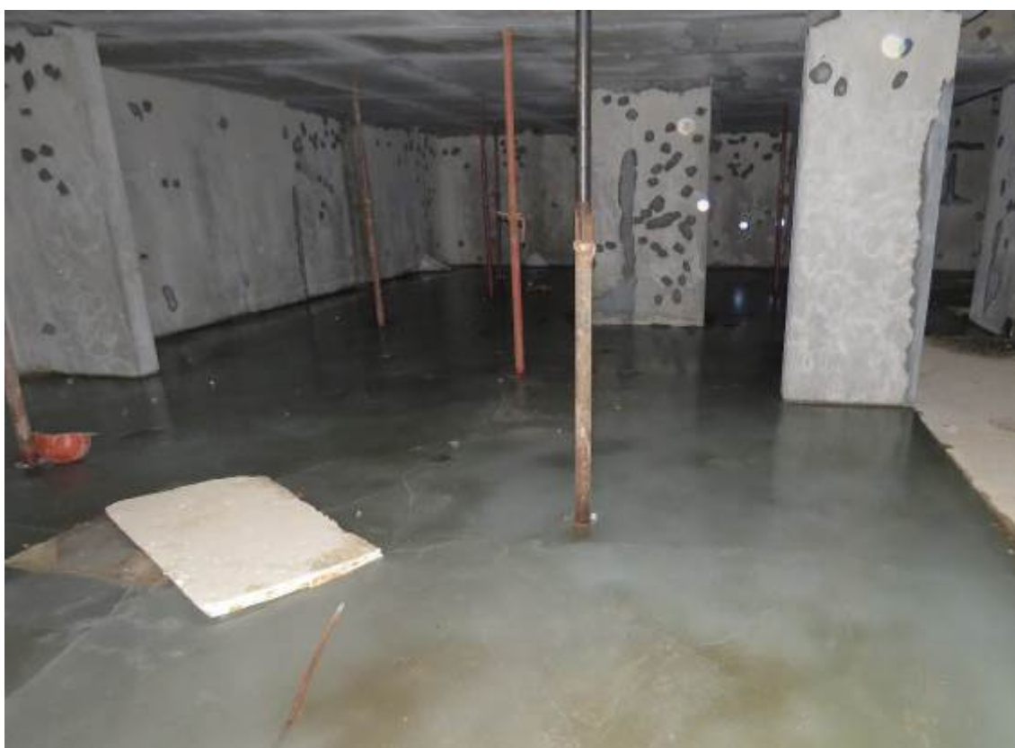
Рис. 3.1.15. Скопление воды, наледь до 600 мм на поверхности фундаментных плит в секции № 4
