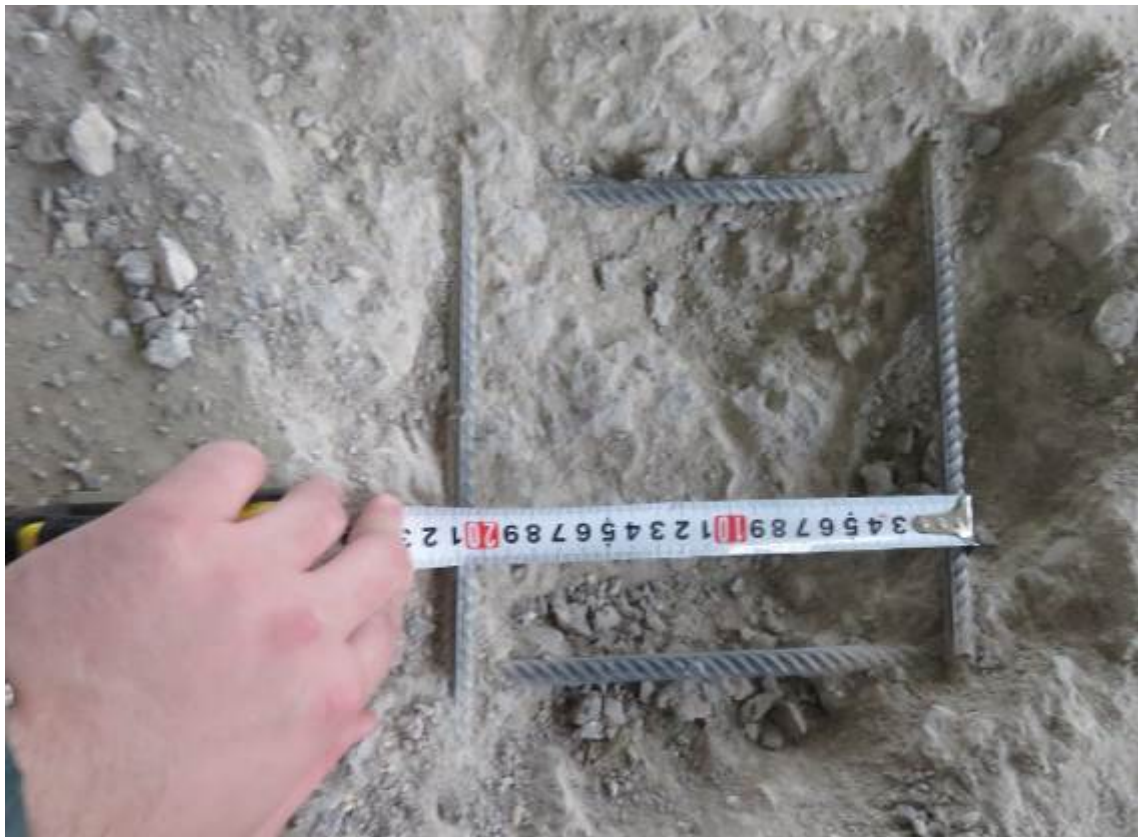
Рис. 3.3.2. Замер шага верхнего армирования монолитной плиты перекрытия подвального этажа в осях 29/2-30/2/А/5-Б/5
