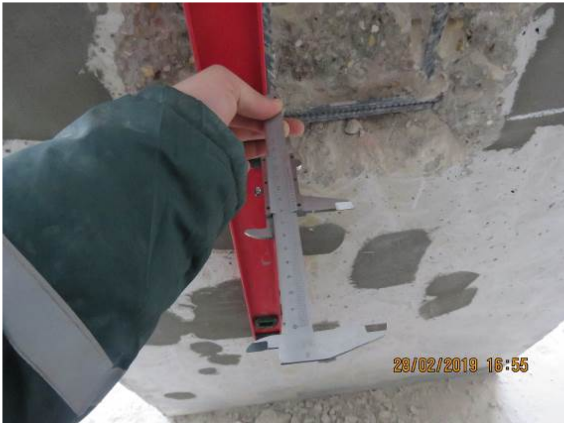
Рис. 3.2.5. Замер защитного слоя бетона в монолитном пилоне первого этажа в осях 11/2/Н/2
