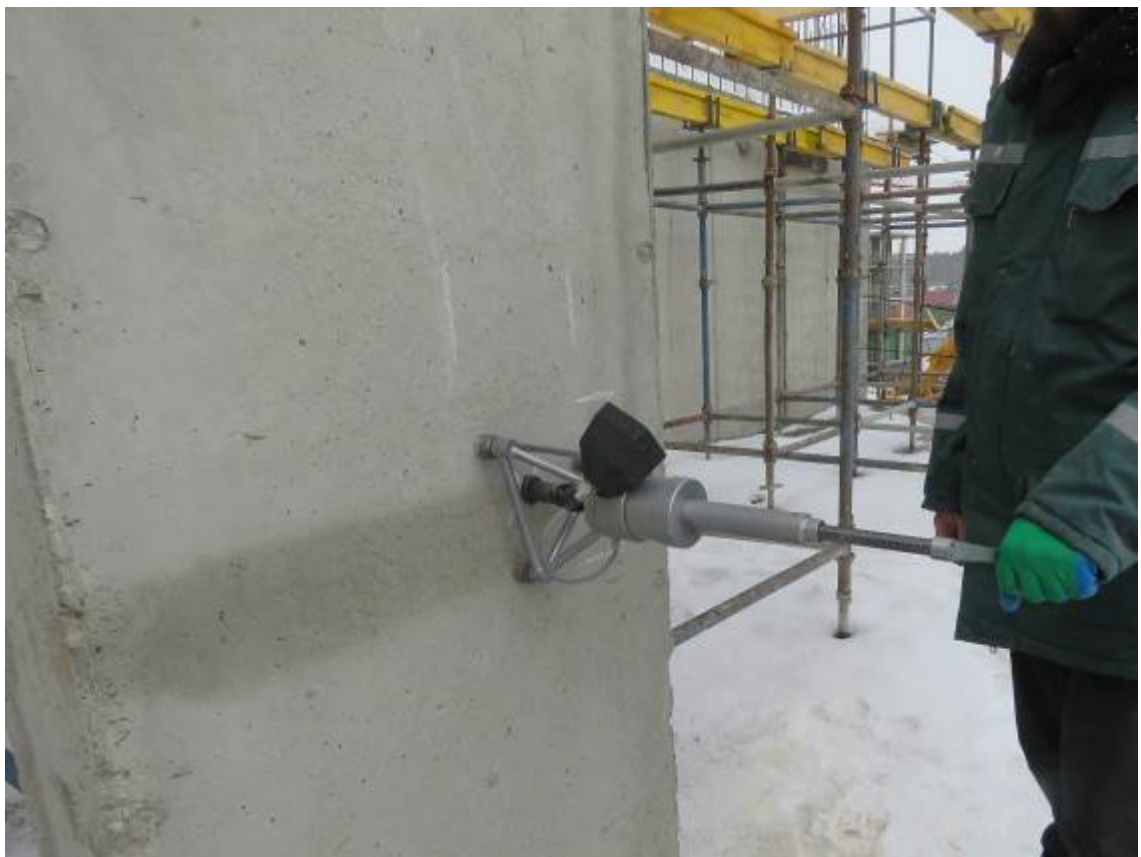
Рис. 4.2.4. Испытание бетона монолитного железобетонного пилона третьего этажа в осях 29/2-30/2/В/4 методом отрыва со скалыванием прибором «ПОС 50МГ-4»
