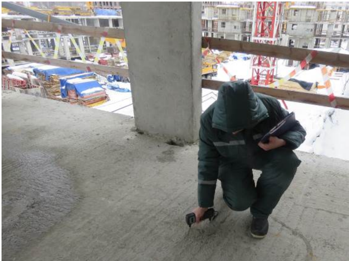
Рис. 4.3.2. Определение скорости ультразвука в монолитной железобетонной плите перекрытия третьего этажа ультразвуковым методом прибором «UK 1401»
