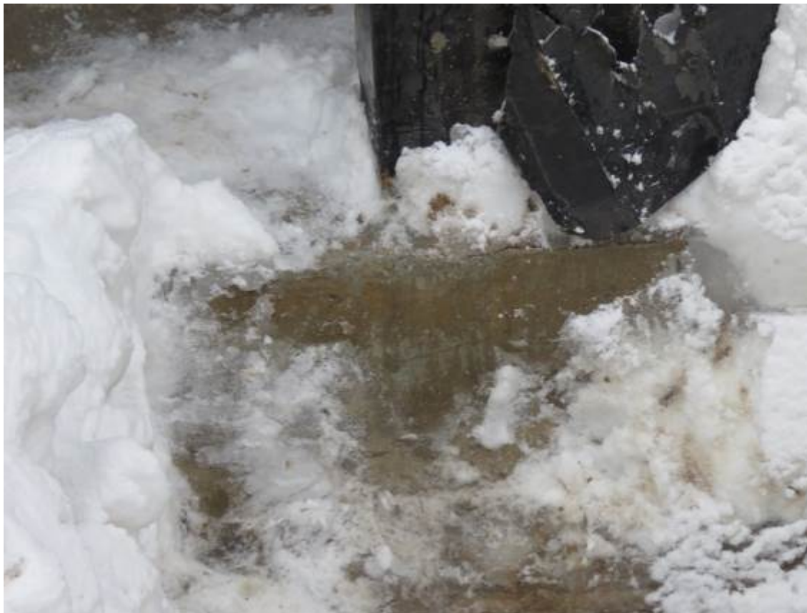
Рис. 3.1.14. Отсутствие гидроизоляции на боковой поверхности фундаментной плиты в осях 29/2-30/2/П/2
