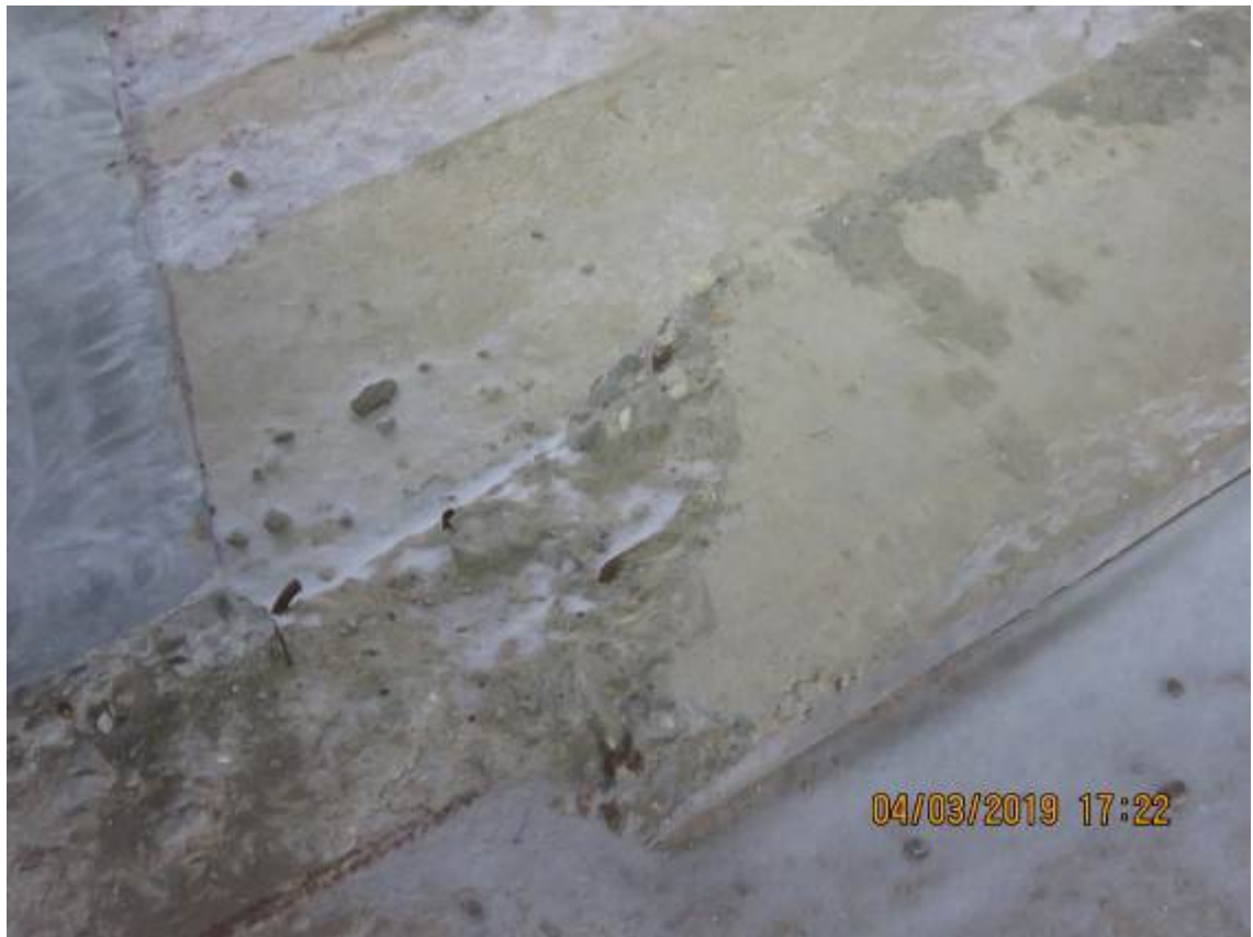
Рис.3.5.9. Механическое повреждение лестничного марша с оголением и коррозией арматуры
