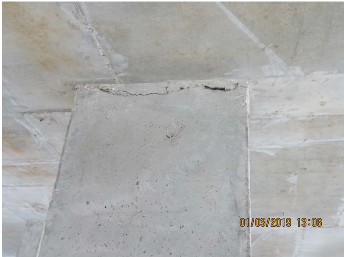
Рис.3.2.24. Уменьшение площадки опирания плит перекрытия на колонны, вызванное скалыванием бетона в узле сопряжения конструкций
