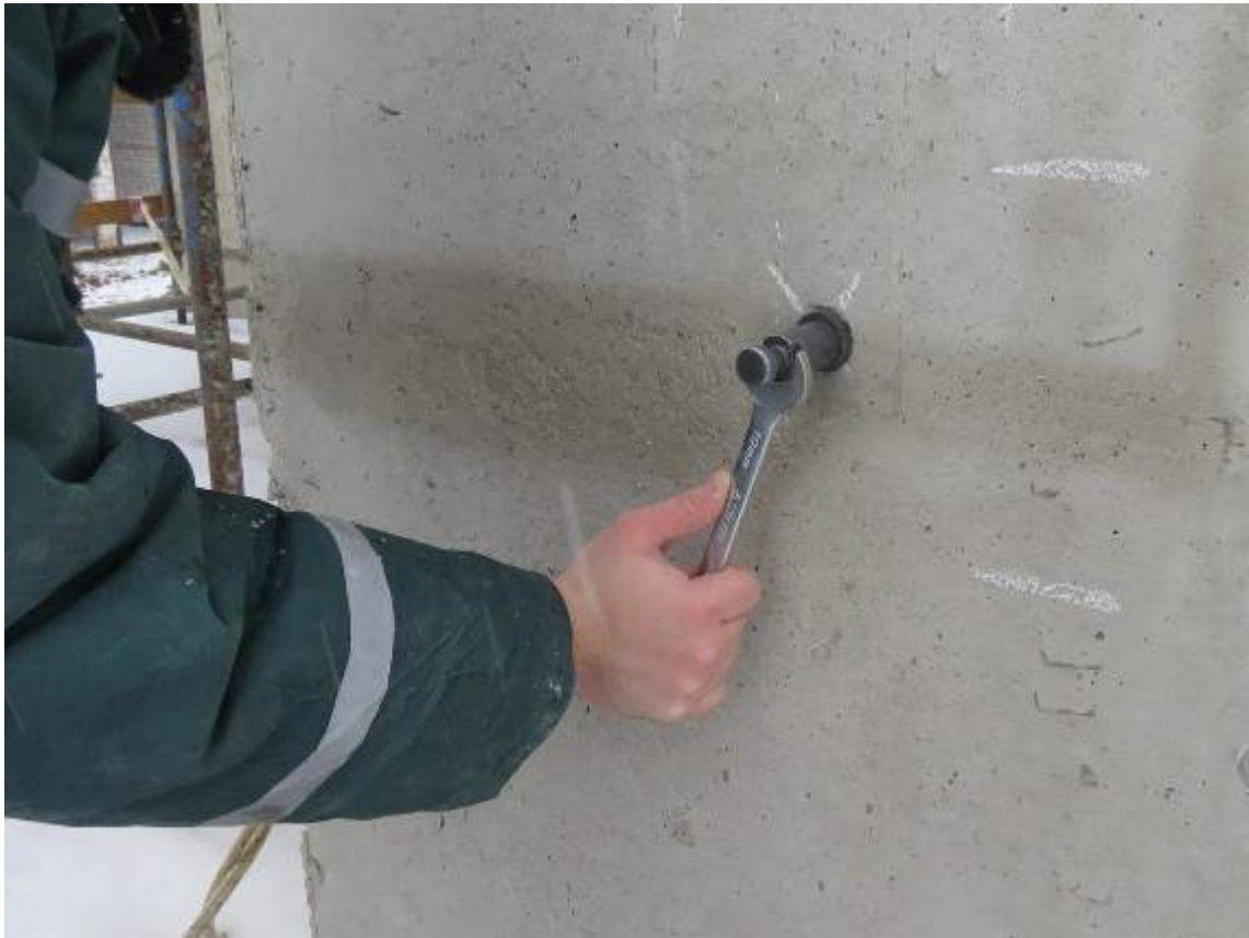
Рис. 4.2.3. Установка анкерного устройства и тяги в отверстии монолитного железобетонного пилона третьего этажа в осях 29/2-30/2/В/4
