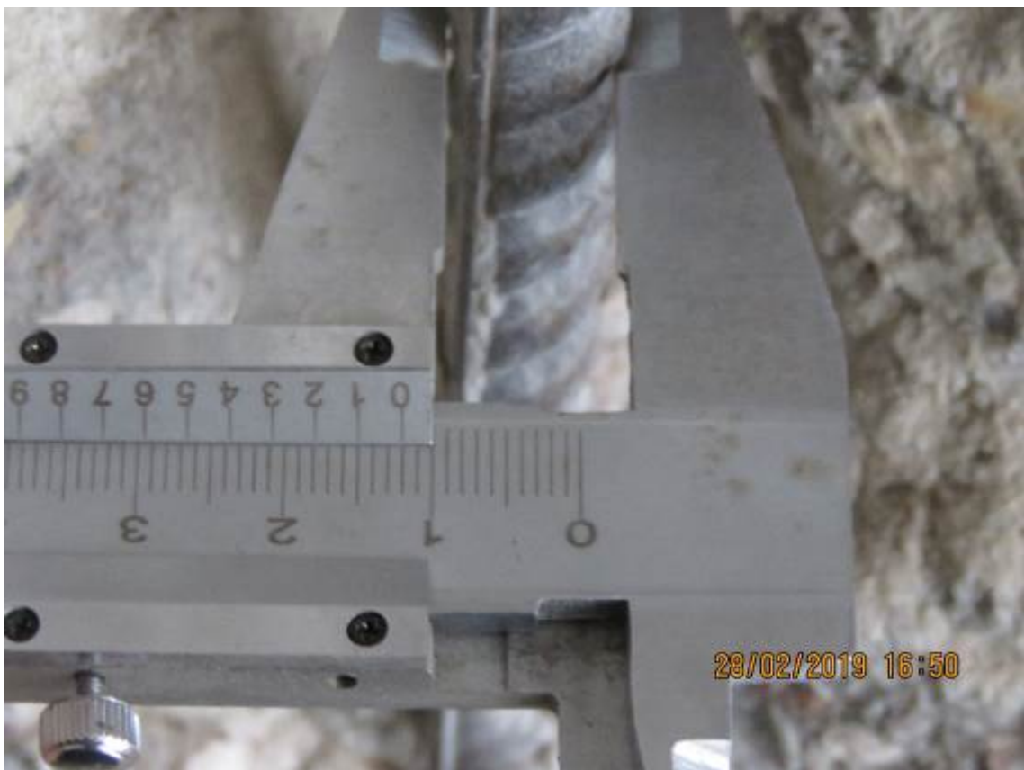
Рис. 3.2.14. Замер диаметра вертикального арматурного стержня в монолитной стене первого этажа в осях 7/2/Л/2-М/2
