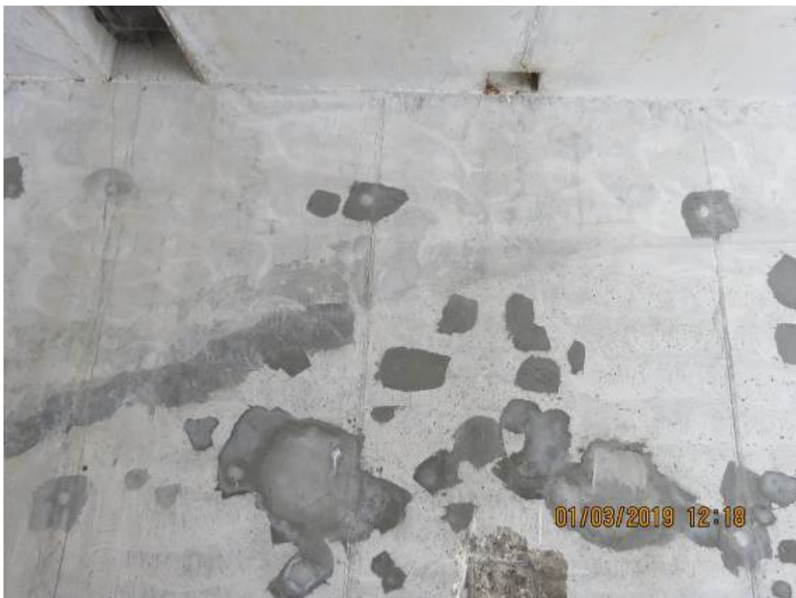
Рис.3.2.20. Участок нарушения технологии бетонирования (косслой)
